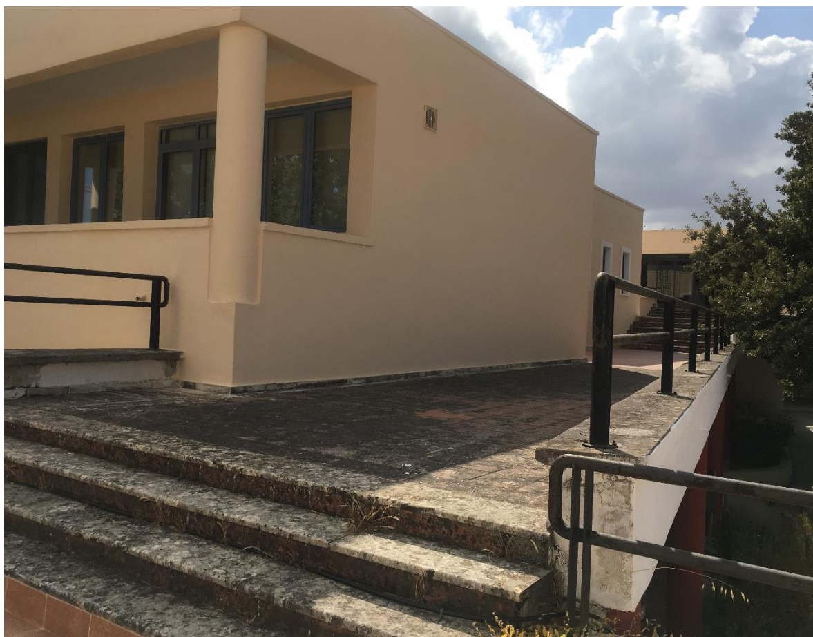
Εικόνα 4_ Υφιστάμενη κατάσταση πλακιδίων Πεζογεφυρών
