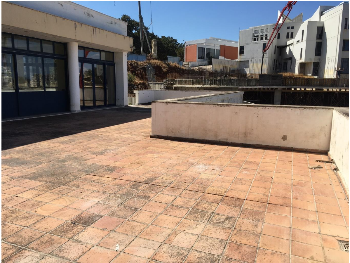
Εικόνα 1_ Υφιστάμενη κατάσταση πλακιδίων Εστιατορίου
